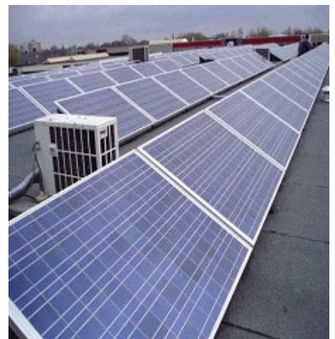
Exemple de panneaux solaires
